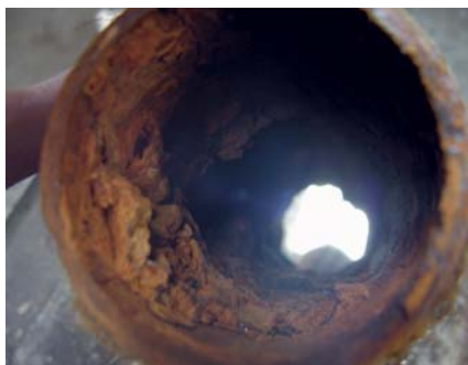
Sinkitty kylmävesiputki ennen Bauer-vedenkäsittelyn asennusta
