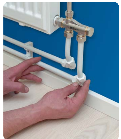
Valkoiset puristusliittimet viimeistelevät ammattimaisen asennustyön.
